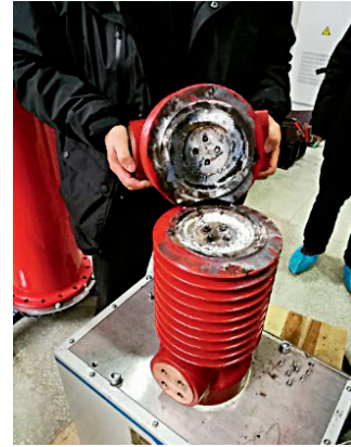
图6 固封极柱断裂
